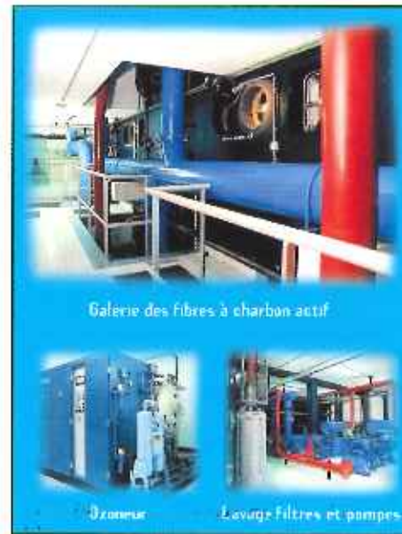
Galerie des fibres à charbon actif Ozoniseur Lavage filtres et pompes
